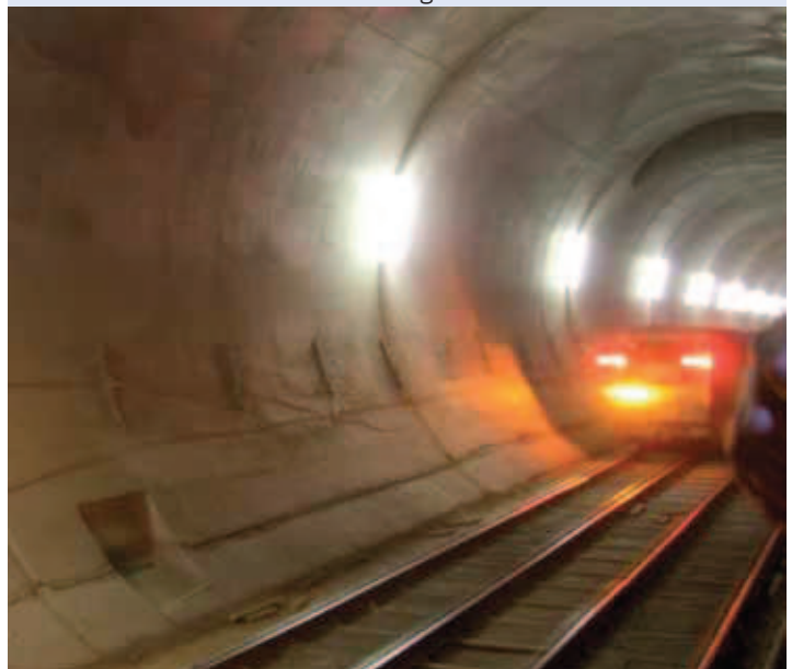
Provisorische Baubeleuchtung im Gotthard Basistunnel
