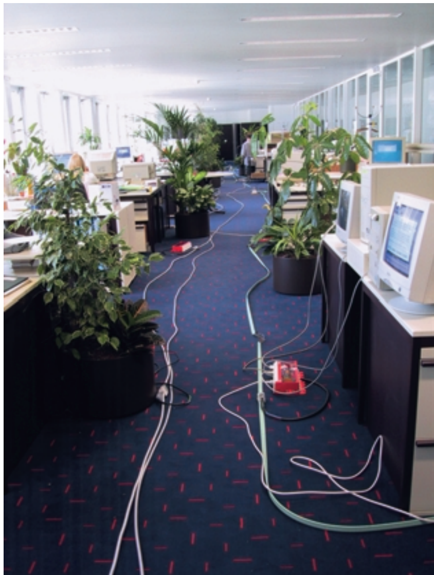
Bild 1 Grossraumbüro in einer Industrieanlage.
